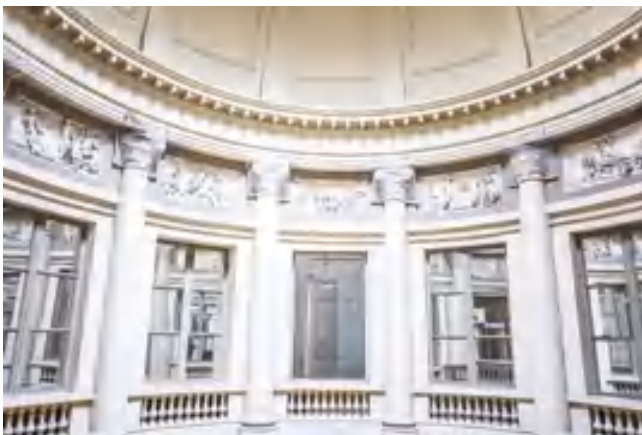
fig. 14 – Dettaglio dell'apparato decorativo in stucco con capitelli ionici fortemente compromessi e bassorilievi parte del ciclo opera dello scultore J.-P. Boiston, che in origine presentava probabilmente una finitura pittorica a simulazione del bronzo (©Nicola Vigilanti, 2020).
