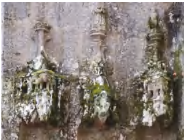
fig. 10 – Moutier-d’Ahun (Creuse), décor flamboyant (dais), façade occidentale datant des environs de 1489, l’ensemble est en ruine depuis 1591 ; un rejointoiement récent est visible (XX e , joints au ciment Portland), cyanobactéries, micro-algues, lichens crustacés et mousses recouvrent les sculptures depuis plus de quatre siècles (Cl. B. Phalip).
