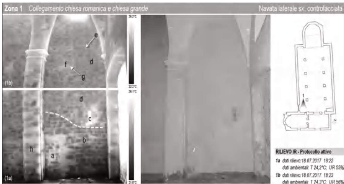
fig. 4 – Bagnasco (CN), chiesa grande di Santa Giulitta, termografia infrarosso della controfacciata (parte orientale).
