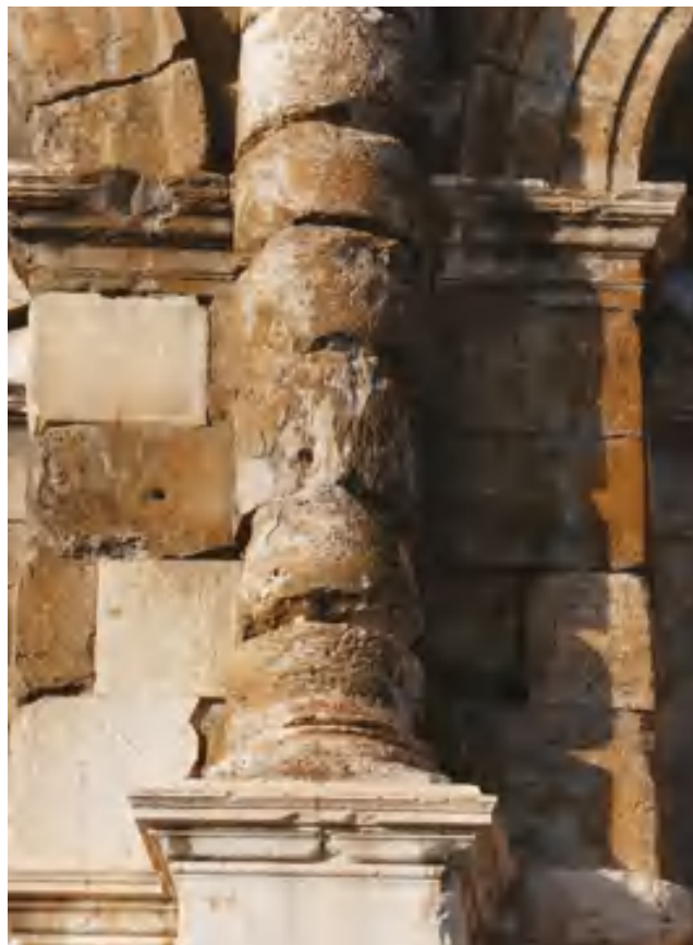
fig. 6 – Nîmes (Gard), les arènes, pierre calcaire d'origine (pierre du Bois des Lens) pourvu de son calcin ; les blocs restaurés en sont dépourvus (Cl. B. Phalip).
