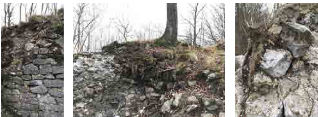
fig. 7 – Da sinistra a destra: apparato radicale insinuatosi lungo l'intera sezione muraria in corrispondenza del settore settentrionale delle mura; essa è una delle principali cause del distacco dei conci lapidei, come dimostra l'andamento della linea del dissesto dell'elevato. Stato di degrado avanzato di una porzione di muratura della porta della fortificazione causato da un esemplare arboreo.
