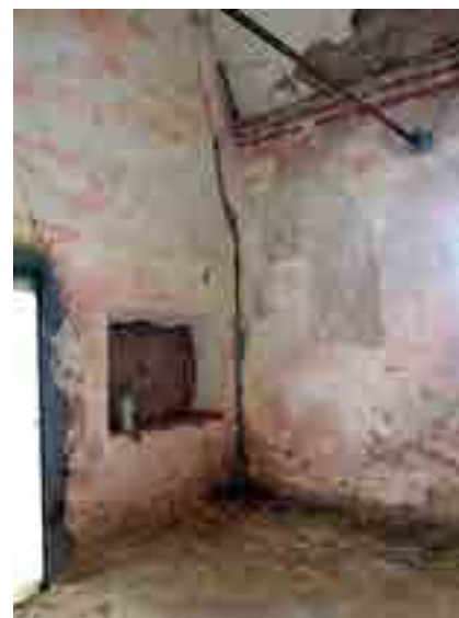
fig. 3 – Bagnasco (CN), chiesa minore dei Santi Giulitta e Quirico. Lesioni nello spigolo interno nord-ovest.
