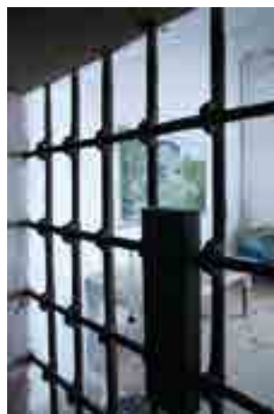
fig. 25 – Bagnasco (CN), chiesa maggiore dei Santi Giulitta e Quirico. Inferriata della finestra votiva di fase 2 nel muro di controfacciata a nord.
