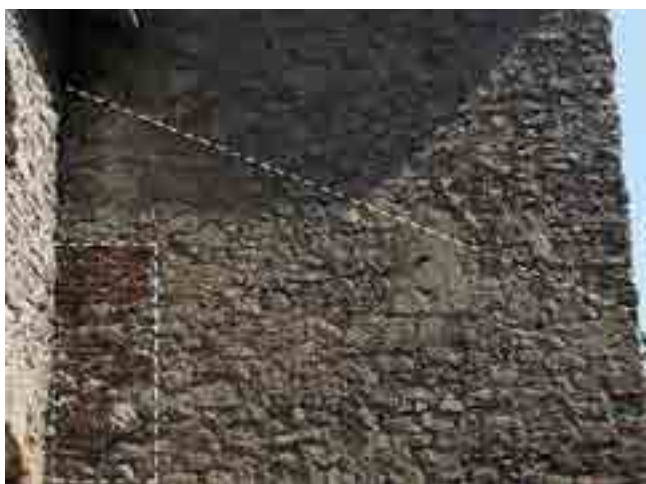
fig. 14 – Parete sud della cappella. I tratteggi indicano la traccia diagonale che separa due fasi costruttive diverse e un'apertura originaria poi tamponata con laterizi misti a pietra.
