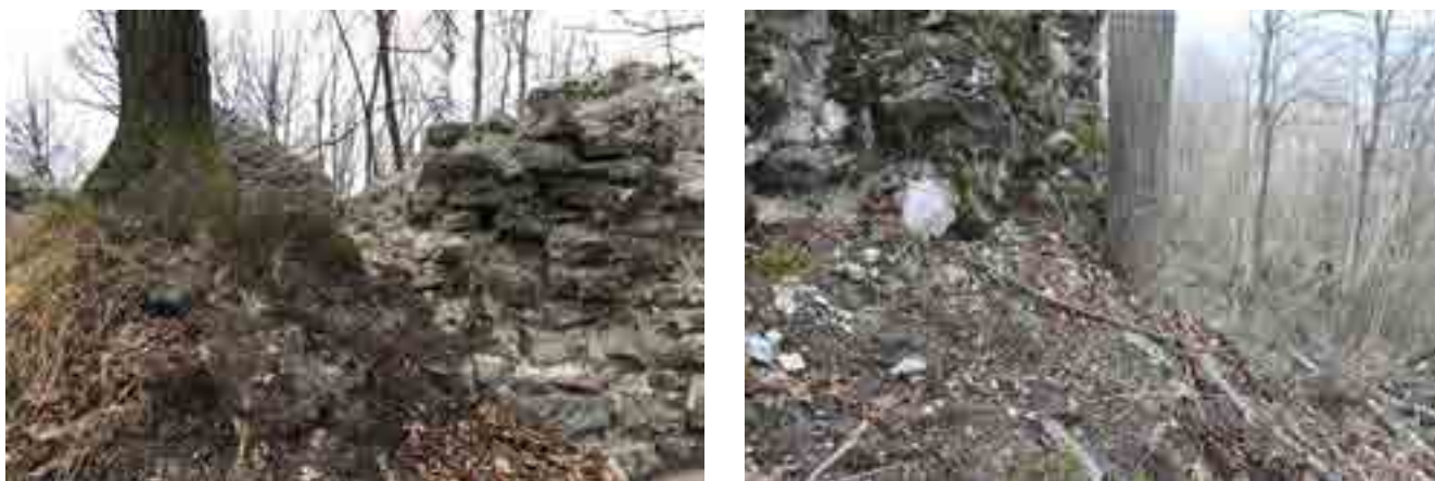
fig. 8 – Esempari arborei che sostengono il paramento murario orientale della torre e quello nord-orientale della fortificazione, entrambi collocati in corrispondenza di forti acclività del terreno.
