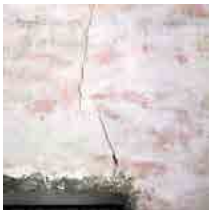
fig. 26 - Particolare della fessura 3 al di sopra del vano di accesso alla cappella.
